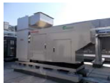
自家発電装置
